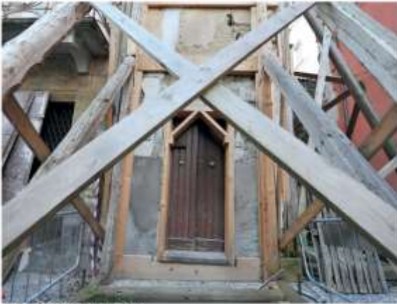
Un edificio inagibile per i danni del sisma
